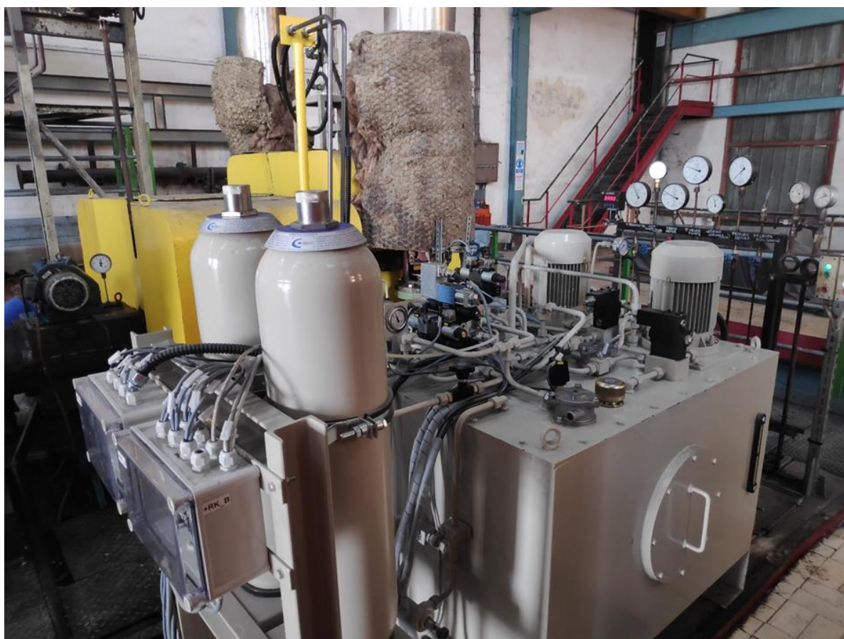
Slika 1: Izgled novog hidrauličnog agregata posle rekonstrukcije
